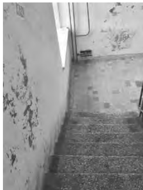
Ненормативное состояние путей эвакуации, ПККПБ
