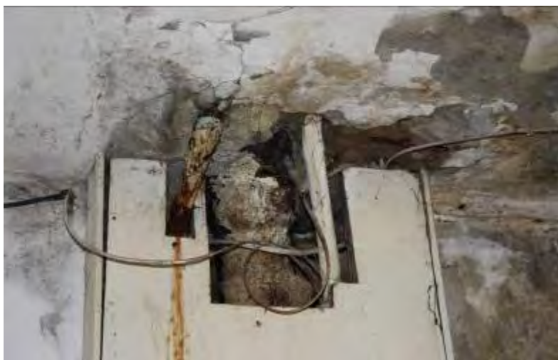
Состояние коммуникаций в ГСУ «Ржевский дом-интернат для престарелых и инвалидов»
