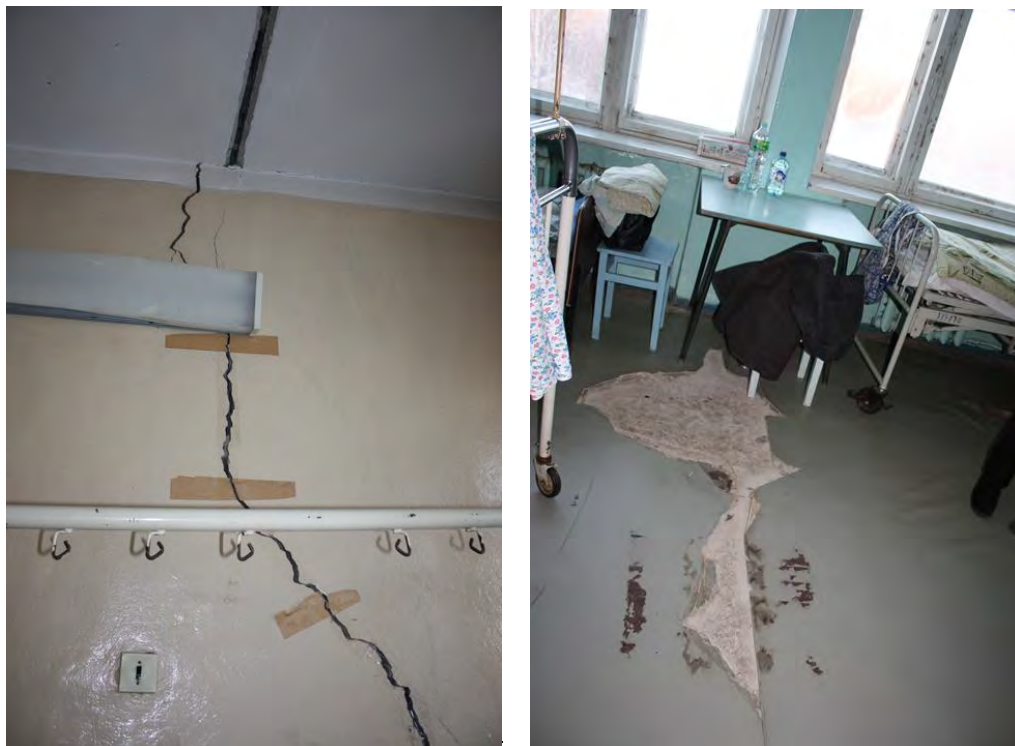
Трещины на стенах, неудовлетворительное состояние линолеума в палатах травматологического и хирургического отделений Кимрской ЦРБ, декабрь 2018 года
